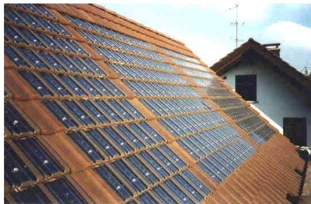
Figura 5. Tejado con celdas fotovoltaicas de Si. Los paneles para tejas tienen solamente 4 mm de grosor y las células de Si policristalino están montadas sobre una superficie de acero inoxidable.
